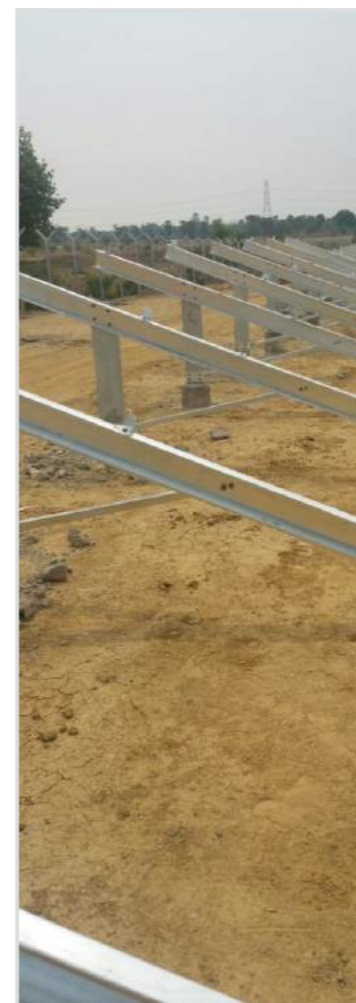
项目地 Project sites: India 容量 Volume: 40MW 时间 Time: 2016.3
