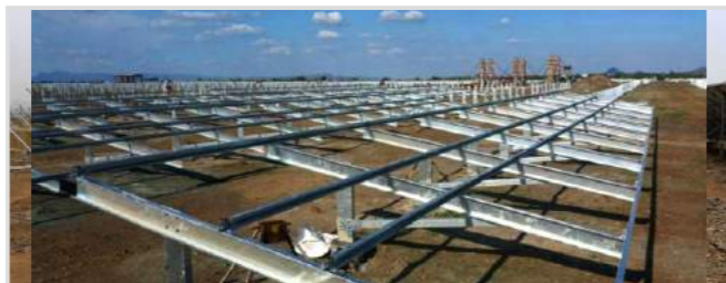
项目地 Project sites: India 容量 Volume: 90MW 时间 Time: 2015.9~2015.12
