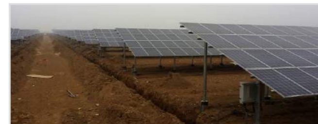
项目地 Project sites: Shandong 容量 Volume: 20MW 时间 Time: 2016.4
