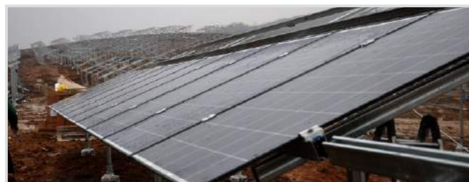
项目地 Project sites: Wuhan 容量 Volume: 30MW 时间 Time: 2015.5
