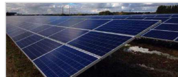
项目地 Project sites: UK 容量 Volume: 15MW 时间 Time: 2015.4
