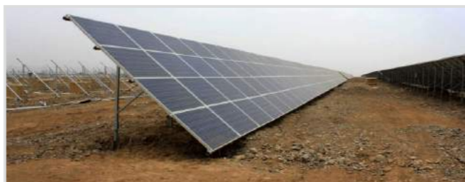
项目地 Project sites: Yunnan 容量 Volume: 50MW 时间 Time: 2015.10
