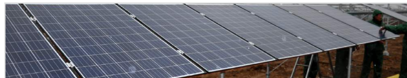
项目地 Project sites: Dongying 容量 Volume: 15MW 时间 Time: 2015.4
